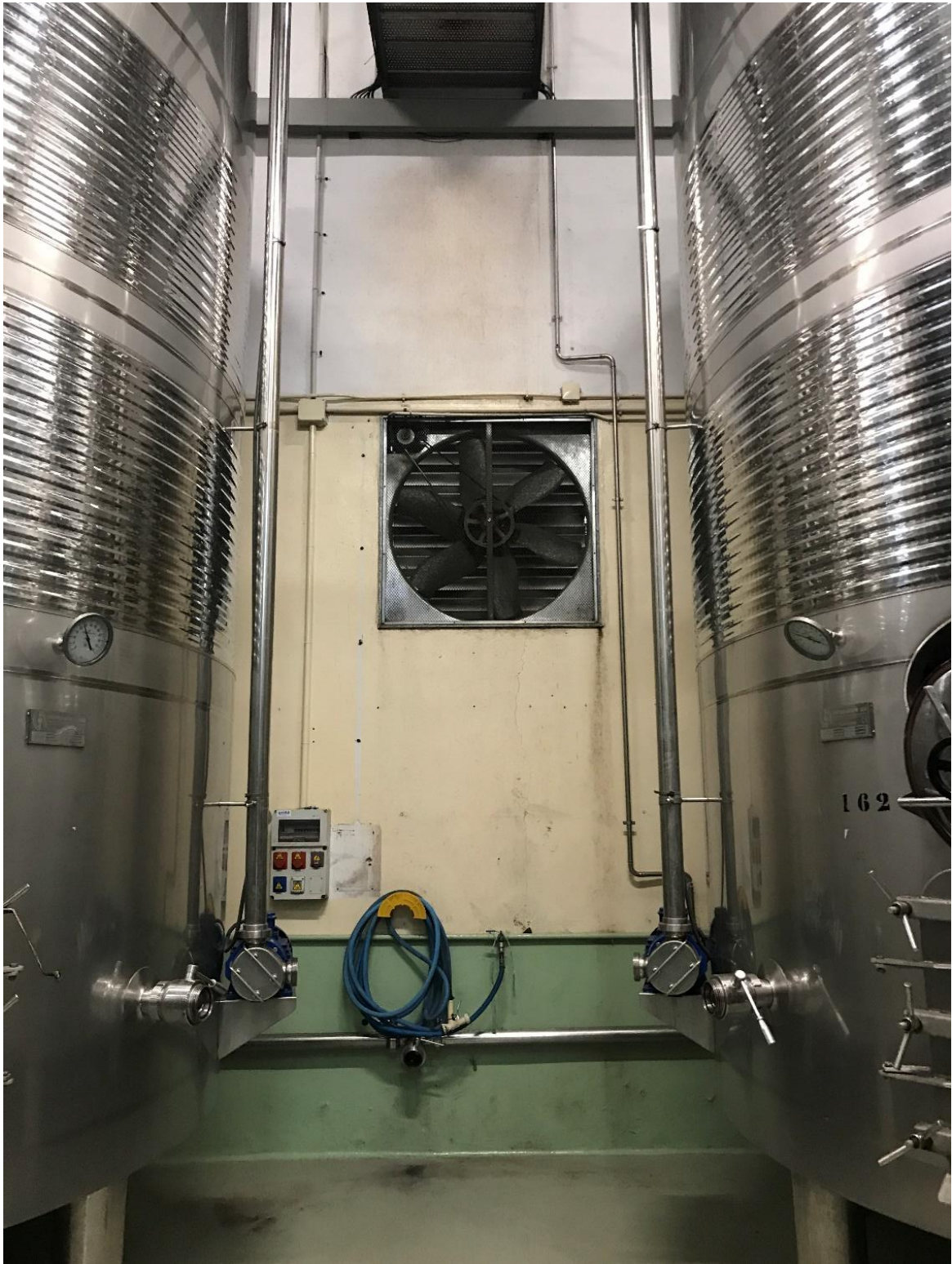
Ilustración 75.- Sistemas de ventilación y renovación de aire en plantas visitadas 2.
