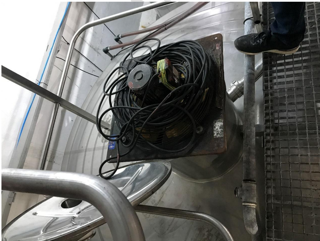
Ilustración 70.- Fotos de sistema de ventilación previa de depósitos establecido en protocolo.
