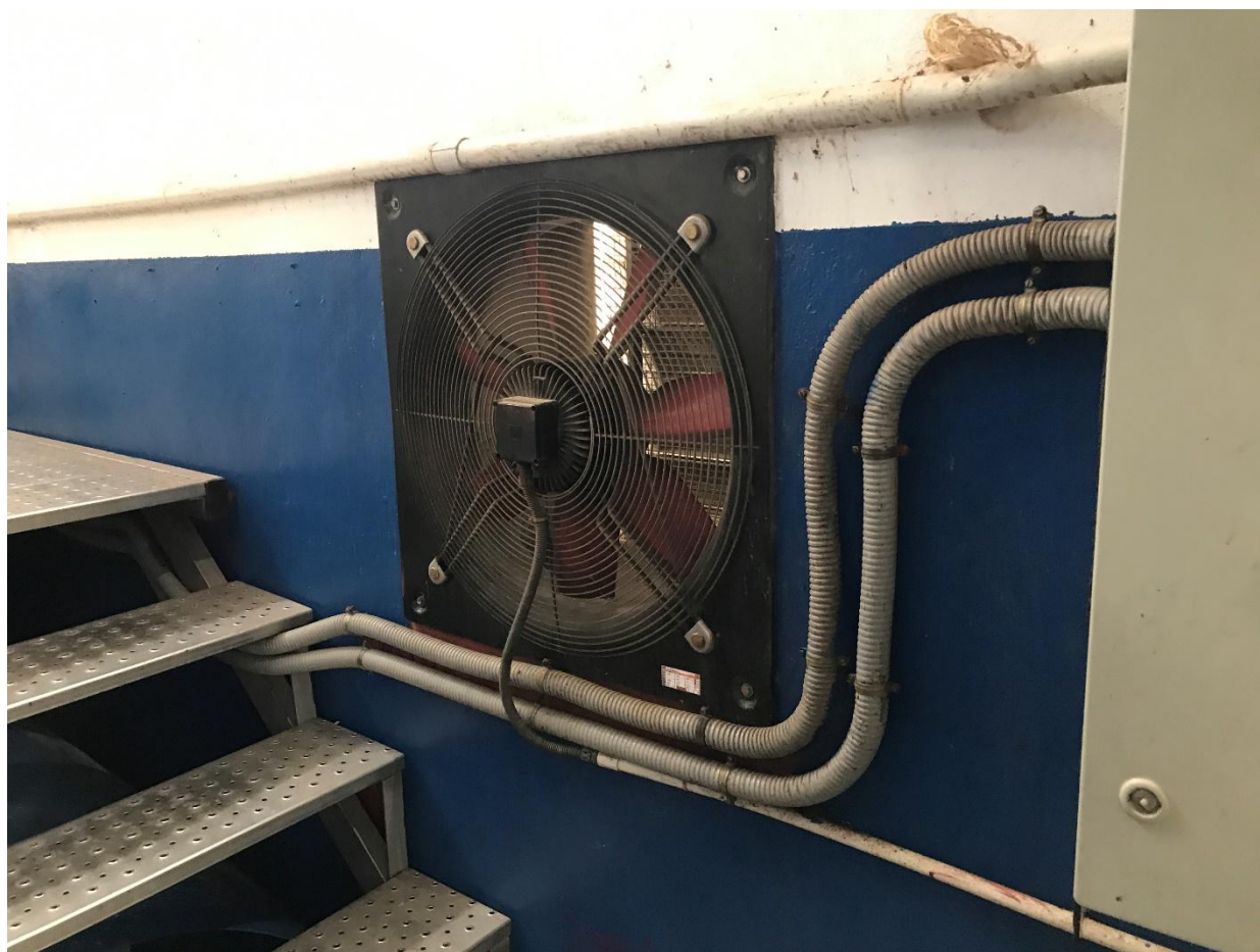
Ilustración 76.- Sistemas de ventilación y renovación de aire en plantas visitadas 3.
