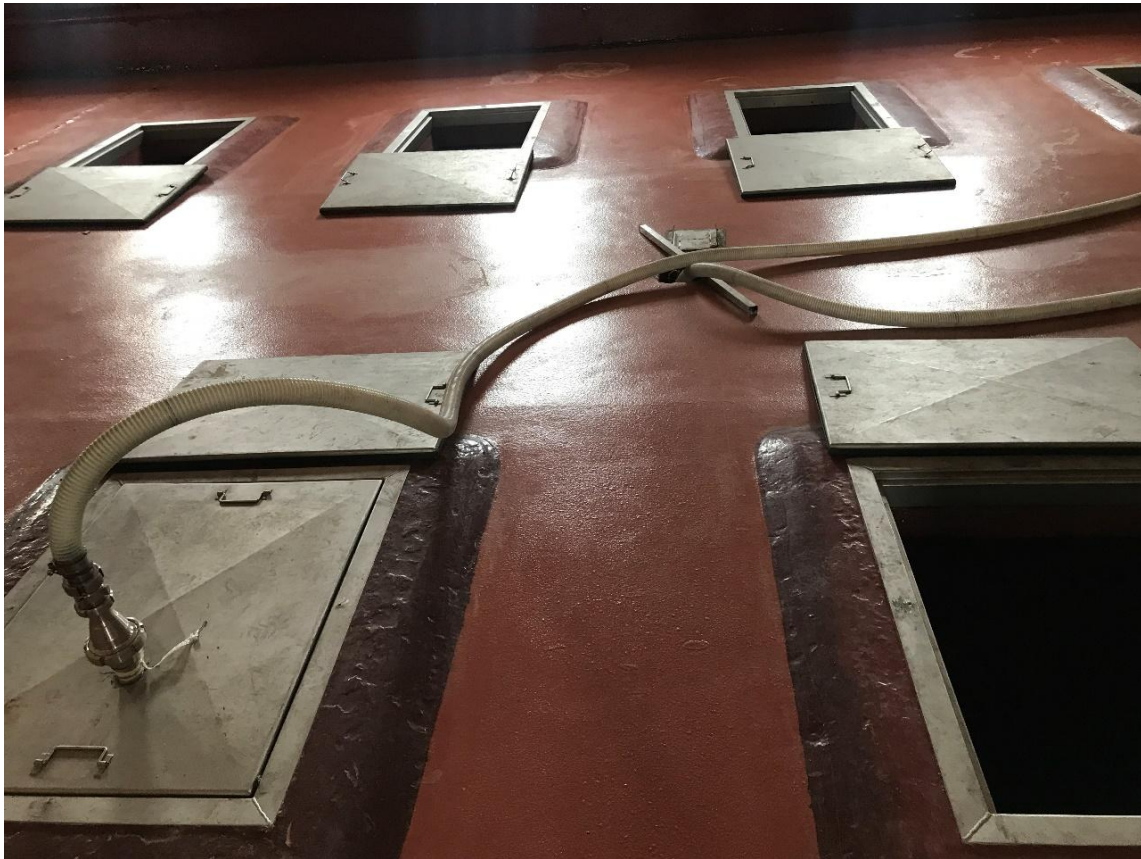
Ilustración 11.- depósitos subterráneos. imagen obtenida de las visitas realizadas a bodega.
