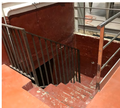
Imagen 10: Espacios subterráneos con riesgo de acumulación de tufo
