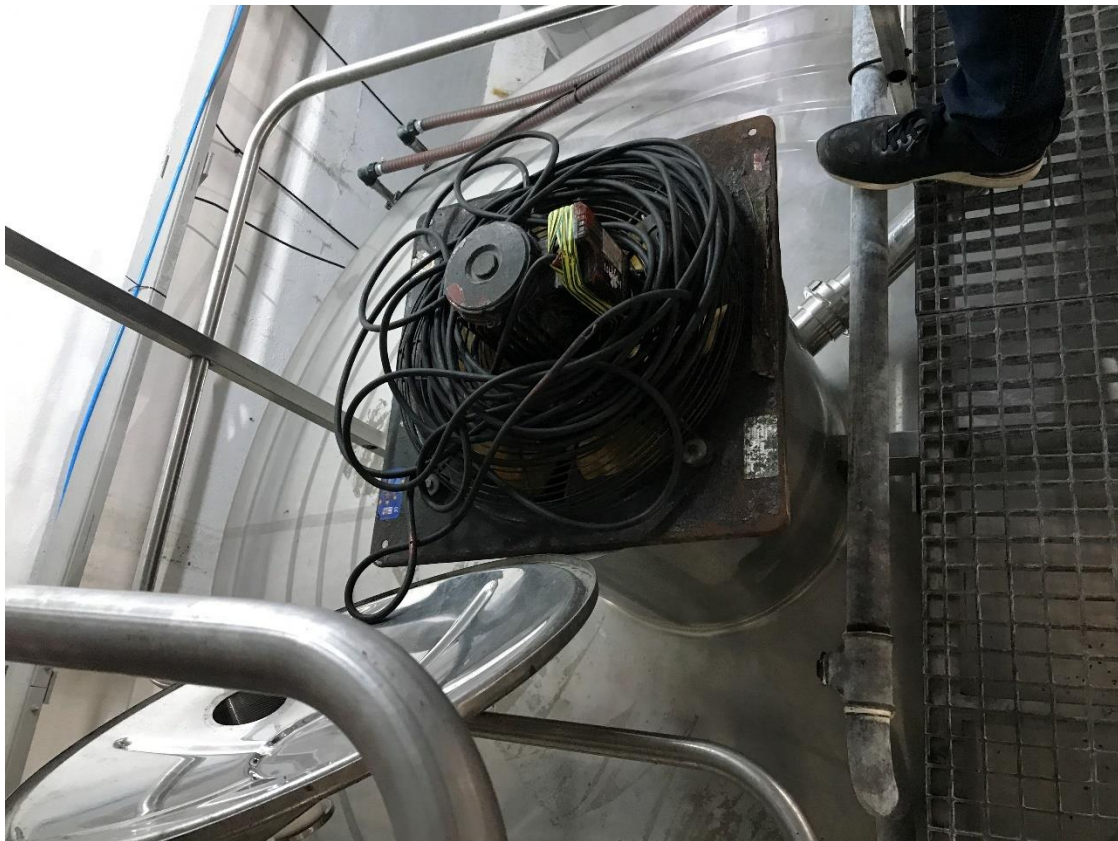
Ilustración 59.- Fotos de sistema de ventilación previa de depósitos establecido en protocolo.
