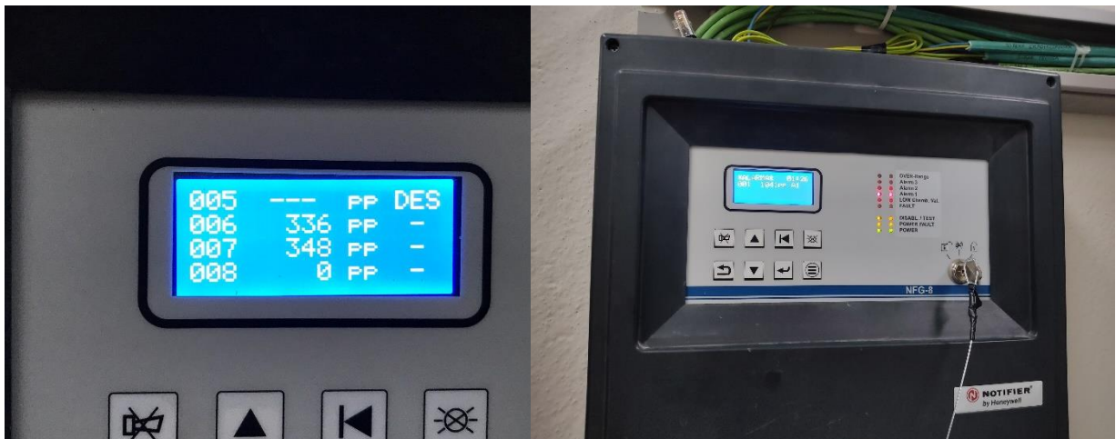
Ilustración 67.- Sistemas de ventilación y renovación de aire activado por detección en plantas visitadas.
