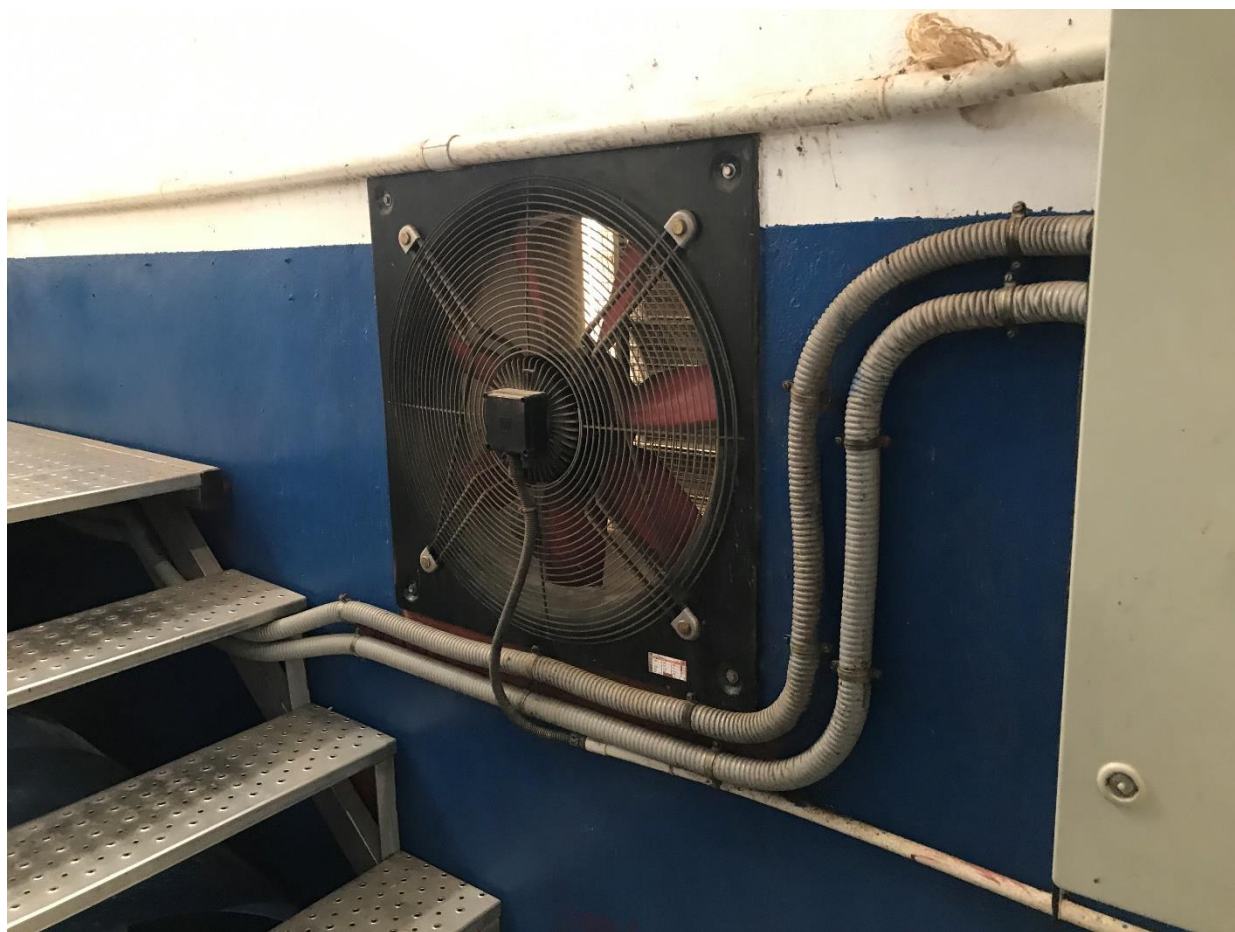
Ilustración 65.- Sistemas de ventilación y renovación de aire en plantas visitadas 3.
