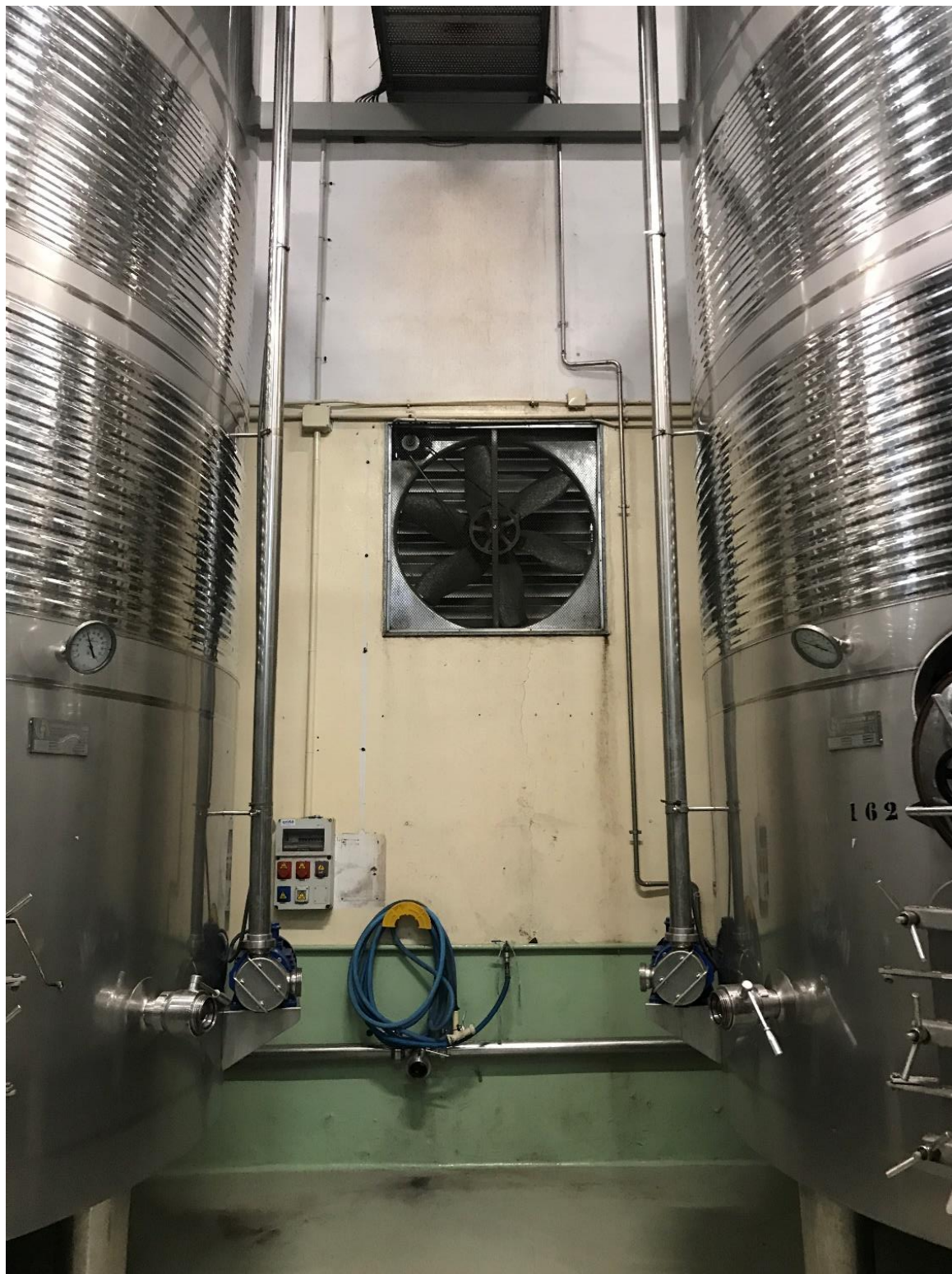
Ilustración 64.- Sistemas de ventilación y renovación de aire en plantas visitadas 2.
